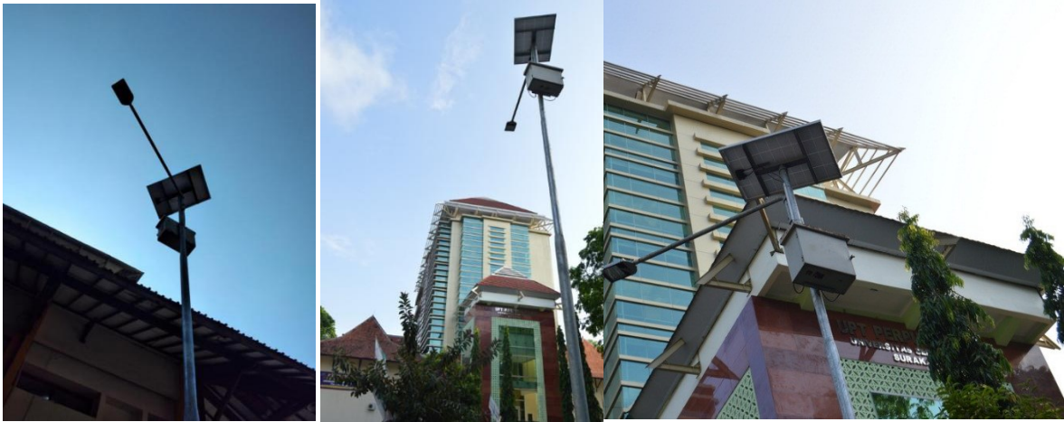
Gambar 3.14. Tenaga Surya Untuk Penerangan Lingkungan Di Luar Gedung Perpustakaan
